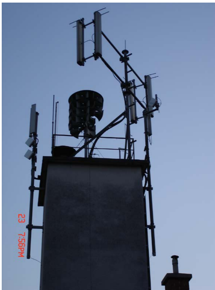
Slika 4: Antene na gasilskem domu
