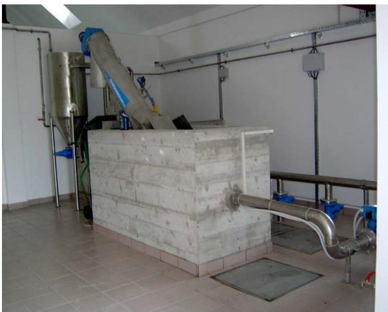
Slika 27: Kanal s finim sitom (polž) (ČN Kostanjevica)
