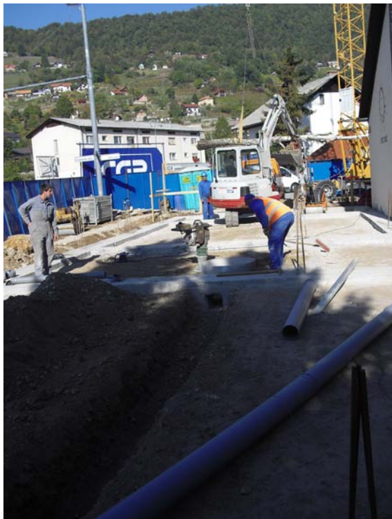
Slika 58: Polaganje cevi za kanalizacijo, postavitev odtokov in jaškov za kanalizacijo (foto: Konda, 2011)
