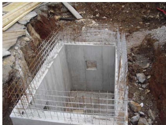
Slika 42: Vodomerni jašek v fazi priprave (foto: Konda, 2011)
