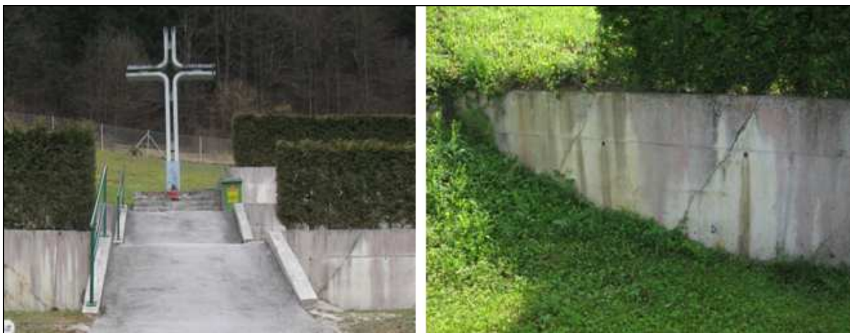
Slika 2: Poškodbe zidov ob klančini in ob terasi
