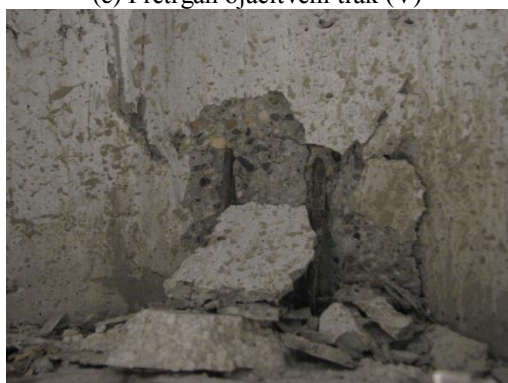
(g) Delaminacija betona zaradi uklonjenih palic (JV)
