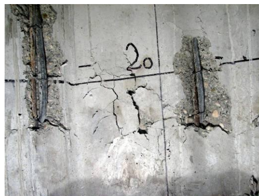
Slika 3.40: Odpadanje betona ob uklonu armaturnih palic na notranji površini stebra NDŠS pri pomiku \Delta = 100,0 mm
