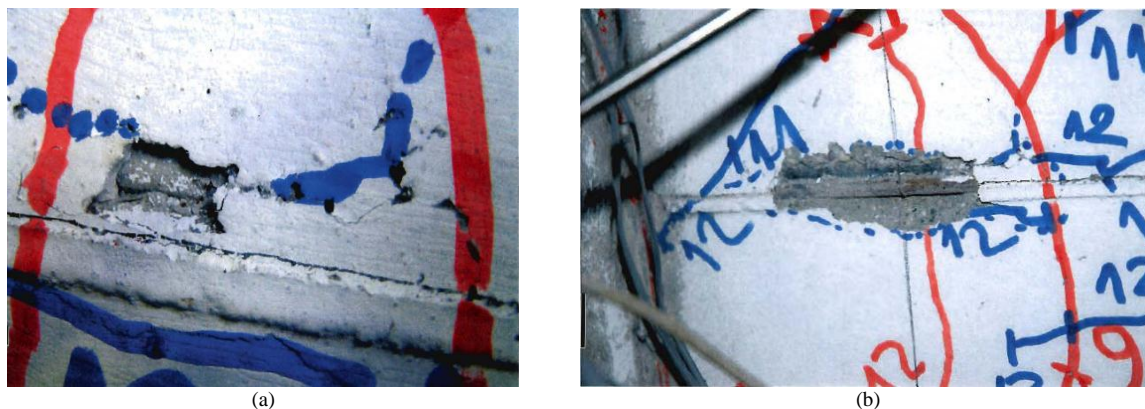
Slika 3.17: (a) Lokalno luščenje betona okoli lokalno razkrite armature v prvem ciklu dvanajste faze ( \Delta=2,7\Delta y ) in (b) Luščenje betona vzdolž armature v trinajsti fazi (Bevc 2006a)
