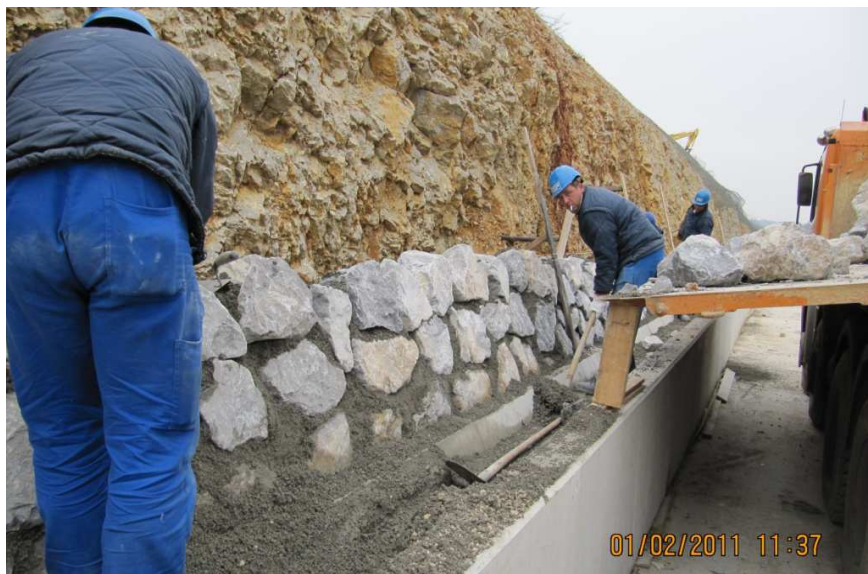
Slika 16: Zaščita brežine z izvedbo AB in kamnitega opornega zidu
