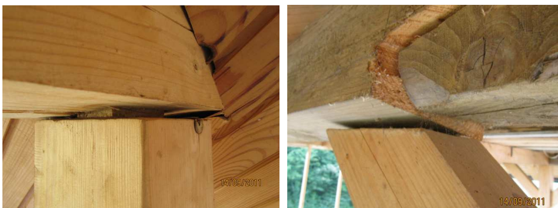
Slika 44: Nekakovostno izvedeni stiki med posameznimi elementi strešne konstrukcije
