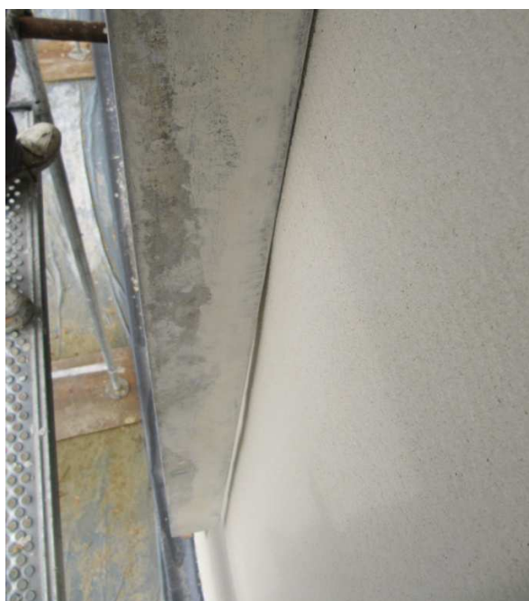
Slika 9: Kontrola ravnosti fasade: izvedba ne ustreza zahtevam standarda
