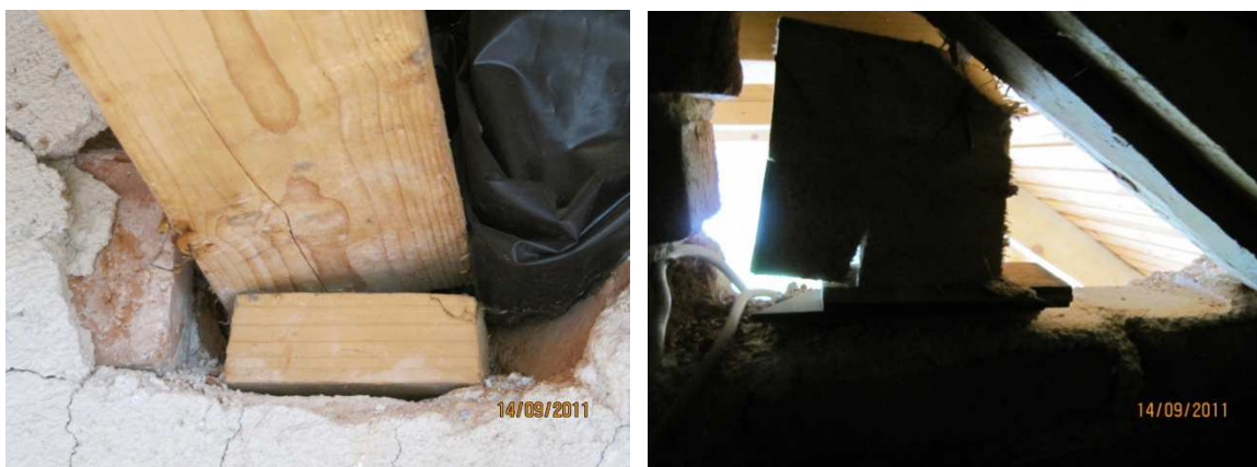
Slika 42: Neustrezna izvedba podpore vmesne lege
