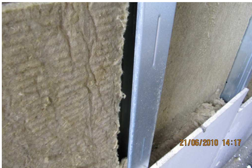
Slika 11: Detajl slabo izvedene izolacije v suhomontažnih stenah
