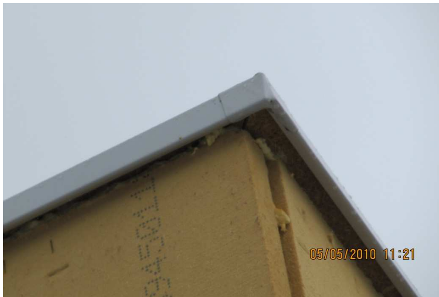
Slika 7: Slabo izveden detajl vogalnega stika toplotne izolacije
