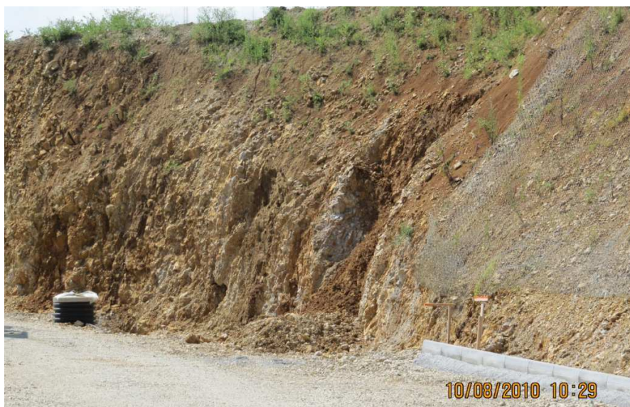
Slika 15: Lokalna porušitev brežine
