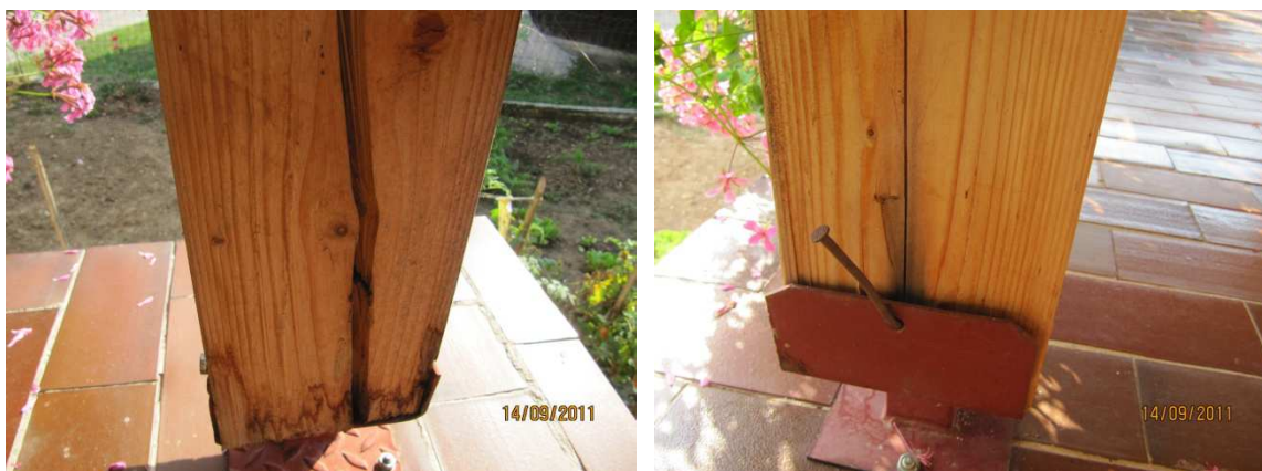
Slika 43: Pojav razpok na vertikalnih nosilnih elementih in neustrezno pritrjevanje na jeklene podstavke
