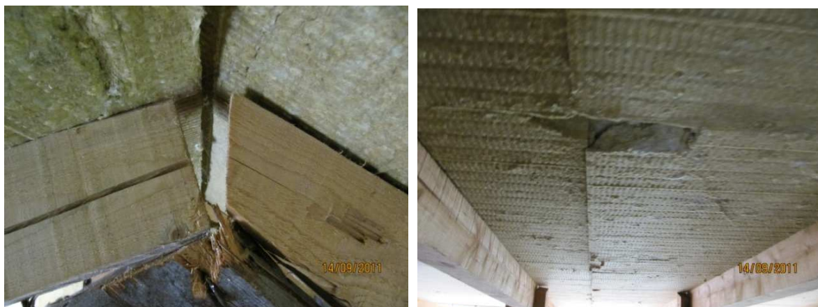
Slika 36: Neustrezni stiki in poškodbe, ki povzročijo nastanek toplotnih mostov
