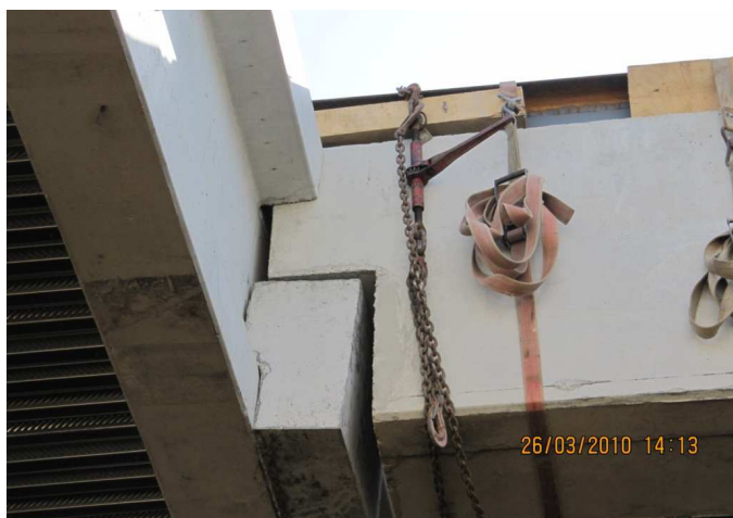
Slika 2: Poškodba armirano betonskega ležišča
