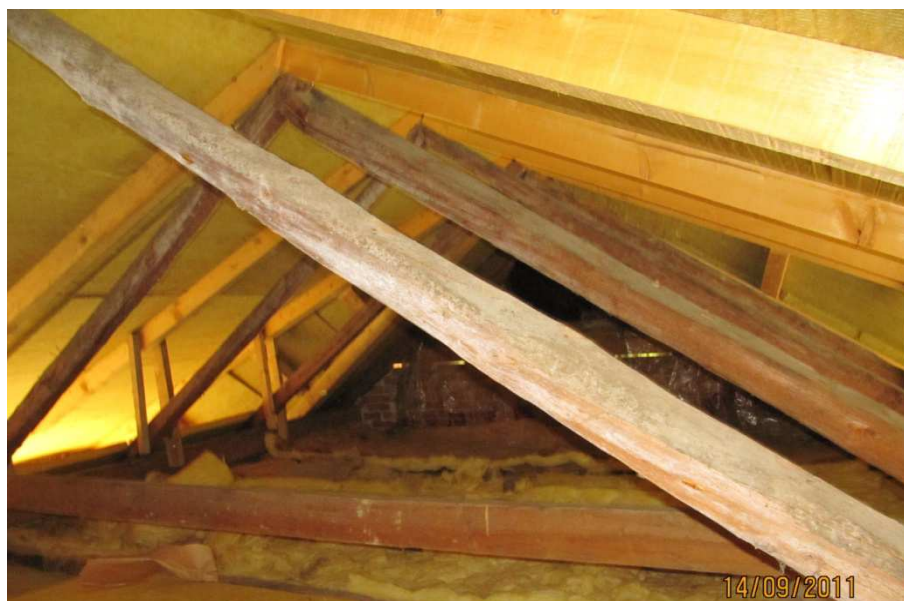
Slika 32: Neustrezna izvedba konstrukcijskega sistema frčade
