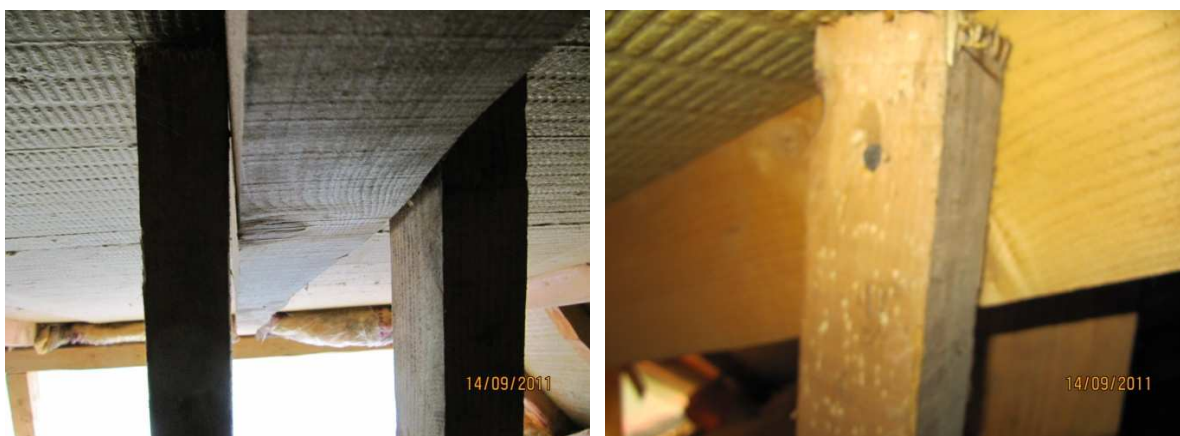
Slika 34: Neustrezna izvedba vertikalnih opor
