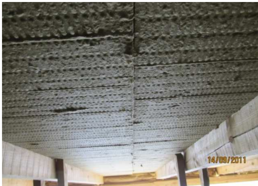
Slika 35: Nepravilno vgrajene plošče toplotne izolacije
