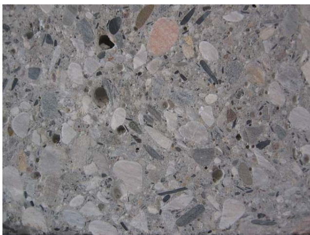
Slika 1: Struktura betona v otrdelem stanju
