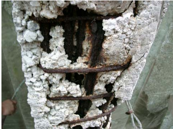
Slika 34: Močna »pitt« korozija armature, ki je posledica prekomerne koncentracije kloridnih ionov
