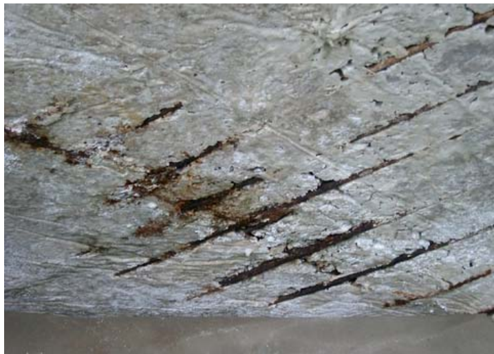
Slika 35: Premajhna debelina zaščitne plasti dovoljuje lažji in hitrejši prodor kloridov do armature
