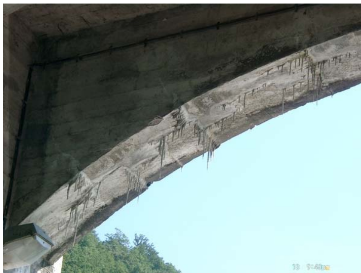
Slika 4: Izločanje sige kot posledica razpada CS-hidratov (vodna pregrada Ajba)
