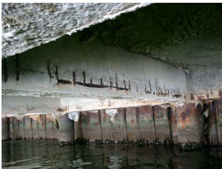
Slika 32: Stanje branaste konstrukcije 8. in 9. veza pred sanacijo
