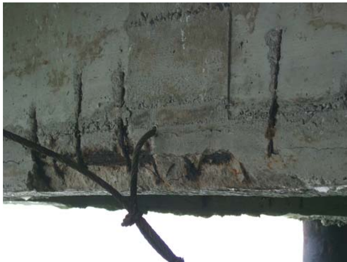
Slika 33: Luščenje zaščitne plasti betona na vogalu AB nosilca zaradi močne korozije armature
