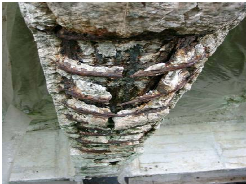
Slika 7: Propadanje konstrukcije zaradi korozije armature kot posledice prodora soli
