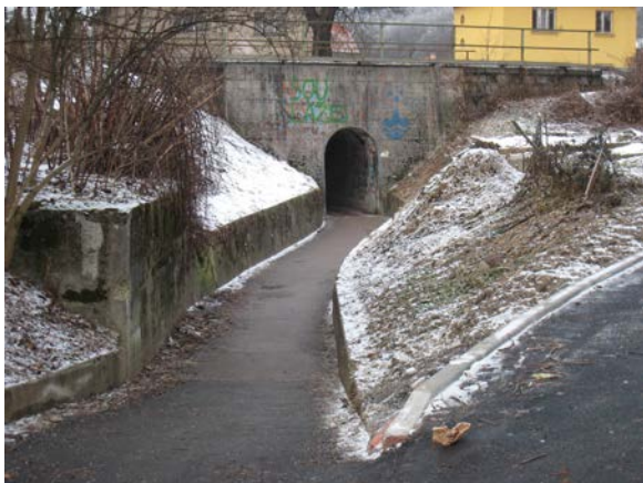
Slika 4.41: Trenutno stanje podhoda na Oražnovi ulici
