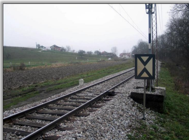
Slika 23: Nerodno postavljena prometna signalizacija
