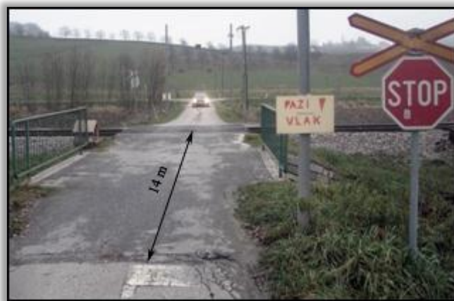
Slika 24: Nepravilna postavitev prometnega znaka
