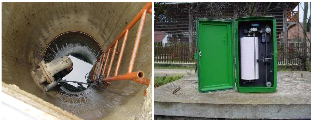
Slika 18: Merilni jašek za analizo stanja podtalnice (levo) in limnigraf (desno)
