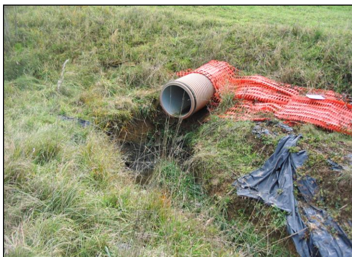
Slika 5: Izpust iz glavnega kanala »S«
