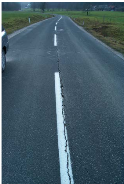
Vzdolžne razpoke – vzdolžni delovni stik (Redno vzdrževanje cest..., 2003: str. 17)
