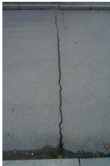
Prečne razpoke zaradi nateznih napetosti (Redno vzdrževanje cest..., 2003: str. 17)
