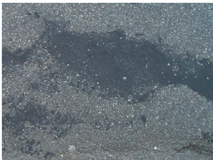
Zmanjšanje torne sposobnosti zaradi iztiskanja bitumenske malte (Redno vzdrževanje cest..., 2003: str. 33)
