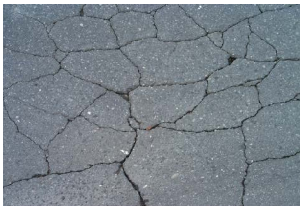
Mrežasta razpoka zaradi spremenjenih materialov v podlagi (Redno vzdrževanje cest..., 2003: str. 17)
