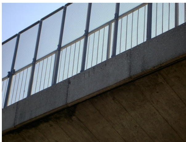
Slika 25: Pretanek krovni sloj betona robnega venca, ki vodi k pojavu korozije armature
