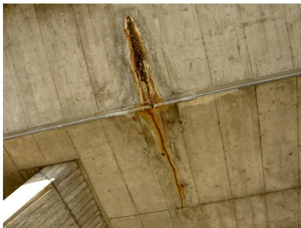
Slika 12: Korozija na površini nosilne plošče nadvoza
