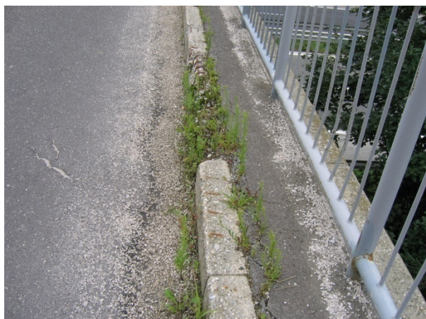
Slika 19: Propadanje betonskega robnika
