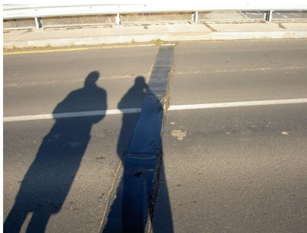
Slika 22: Poškodovan kovinski profil dilatacije
