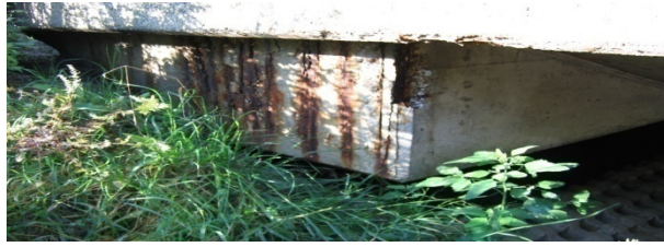
Slika 9: Korozija armature na krilu nadvoza
