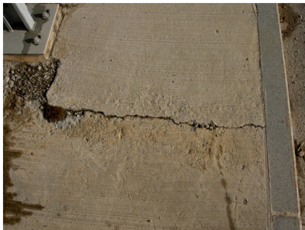
Slika 16: Razpoka na hodniku nadvoza zaradi posedkov krajnega opornika
