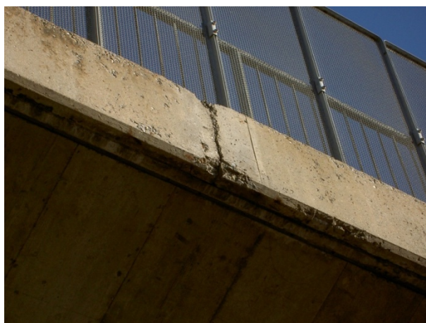
Slika 14: Razpoka robnega venca zaradi utesnjenosti elementov
