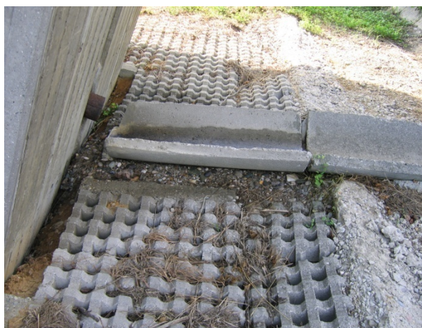
Slika 29: Zamaknjena kanaleta za odtok vode – zaradi posedkov
