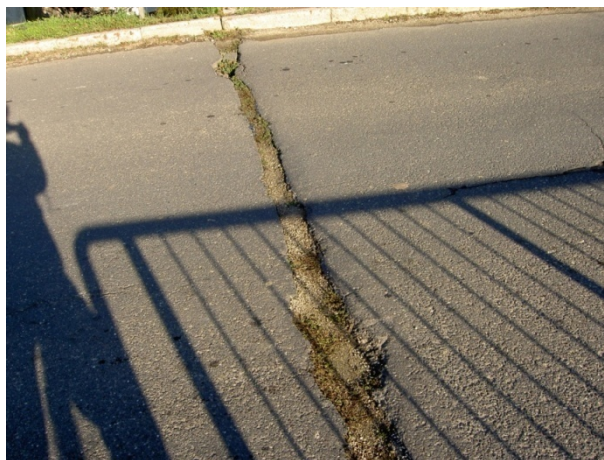
Slika 23: Razpoka v vozišču na mestu dilatacije.
