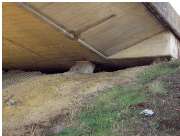
Slika 6: Posedki pod krajnim opornikom in poškodovana brežina nasipnega stožca
