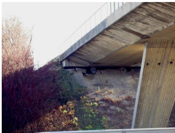
Slika 7: Posedki pod krajnim opornikom in poškodovana obloga nasipnega stožca
