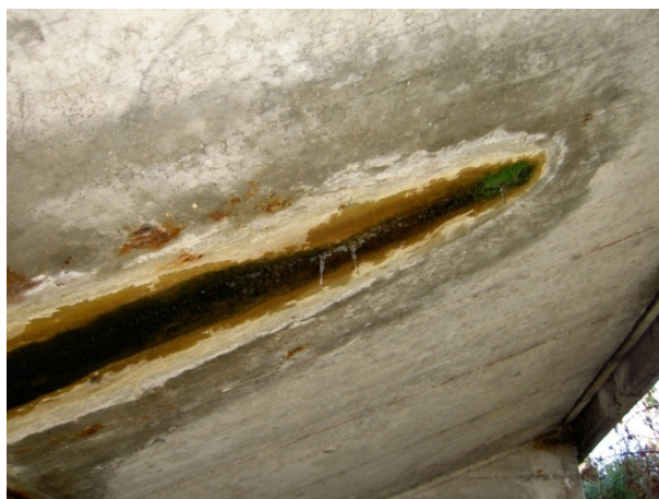
Slika 13: Kristalizirana sol na površini nosilne plošče nadvoza (bele lise)
