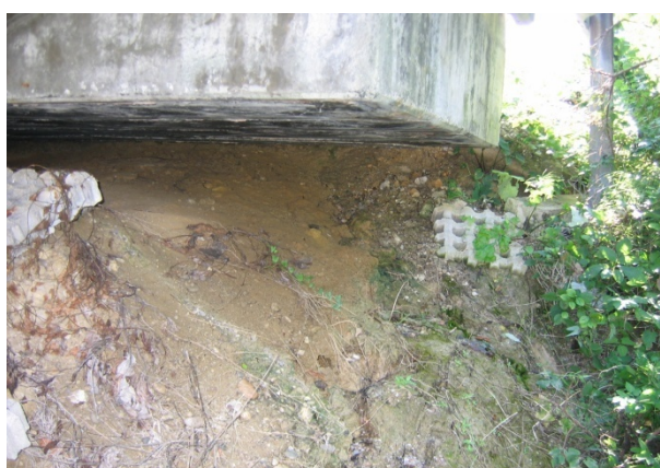
Slika 8: Poškodovan nasipni stožec – erozija
