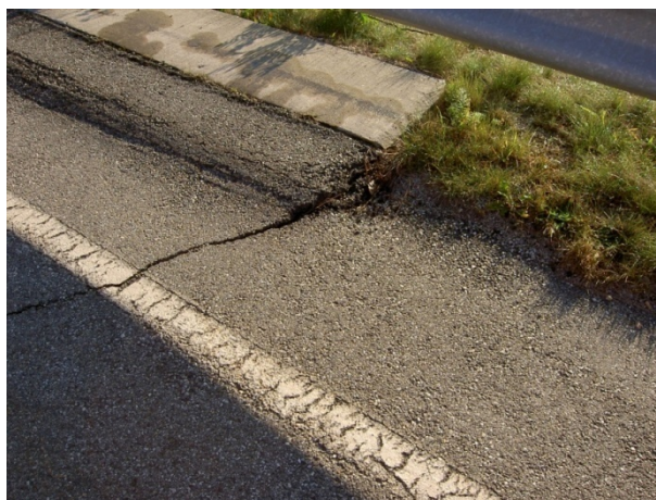
Slika 5: Stopničast prehod na most zaradi posedkov pod krajnim opornikom (poškodba je sicer vidna na cestišču, vendar zaradi vzroka nastanka spada k poškodbam spodnje konstrukcije)
