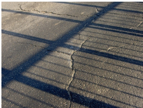
Slika 21: Razpoke asfaltnega vozišča na nadvozu
