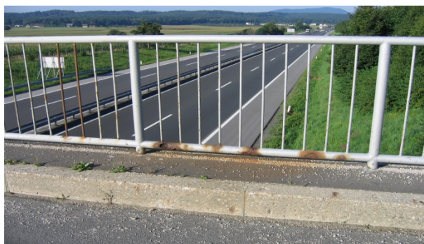
Slika 28: Korozija ograje za pešce na nadvozu
