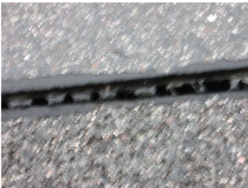
Slika 15: Slaba sanacija razpoke
