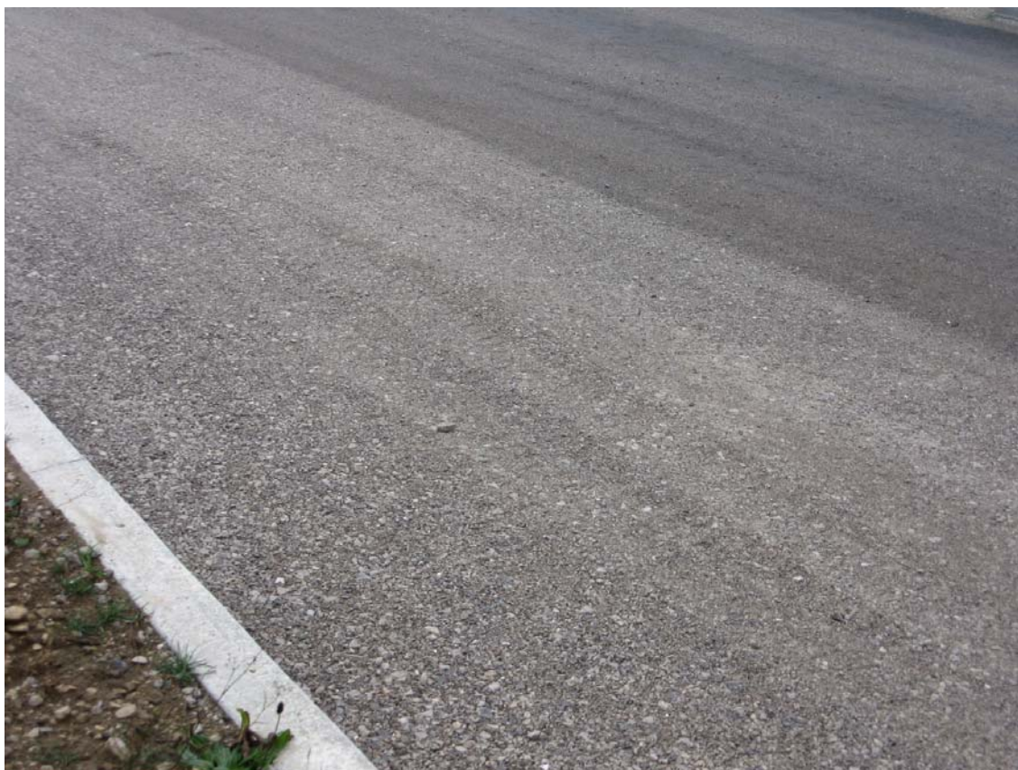
Slika 11: Neustrezno pripravljen planum podlage za vezano zgornjo nosilno plast
