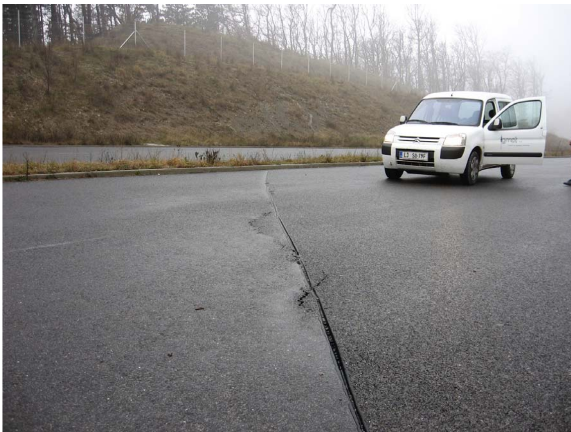
Slika 12: Široke razpoke na voziščni konstrukciji
