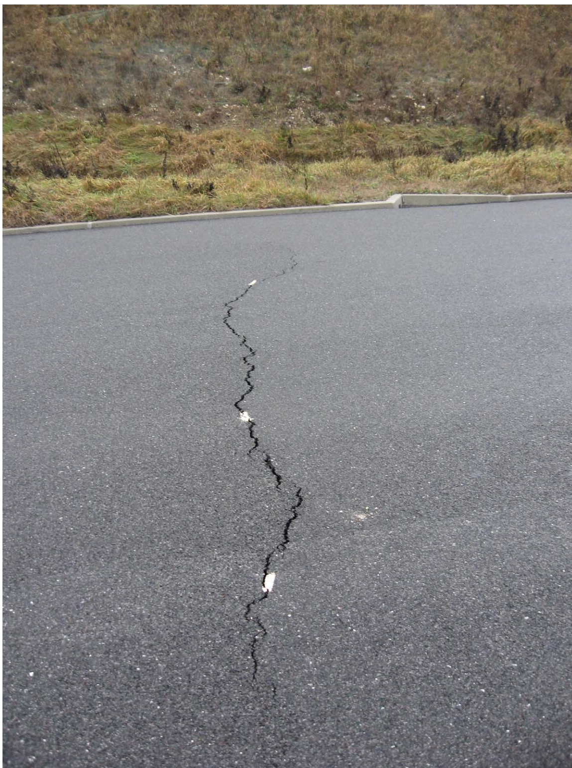
Slika 13: Široke razpoke na voziščni konstrukciji
