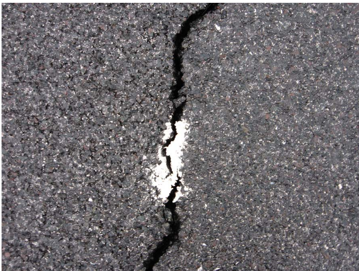
Slika 14: Široke razpoke na voziščni konstrukciji
