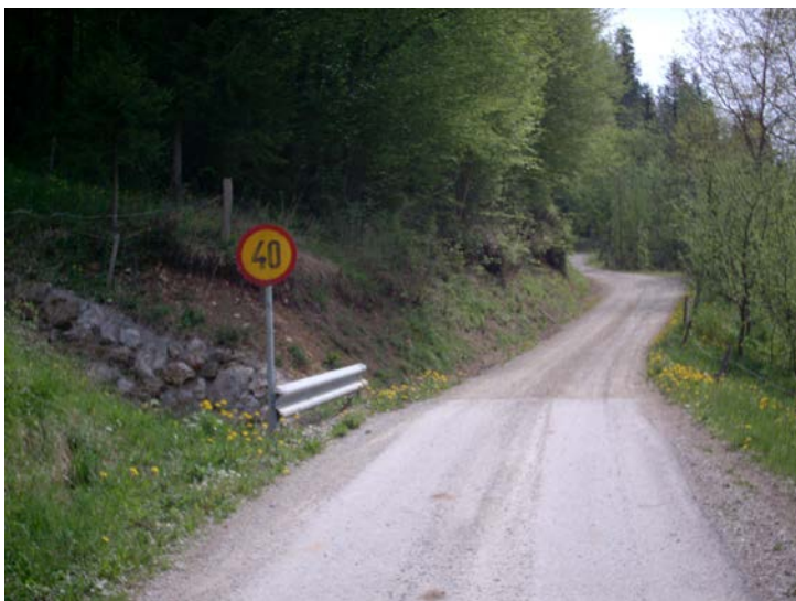
Slika 1: konec asfaltnega in začetek makadamskega vozišča na cesti LC 410040
