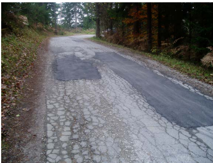
Slika 6: poškodovana cesta v Ravnah pri Šoštanju ( LC 410090 )
