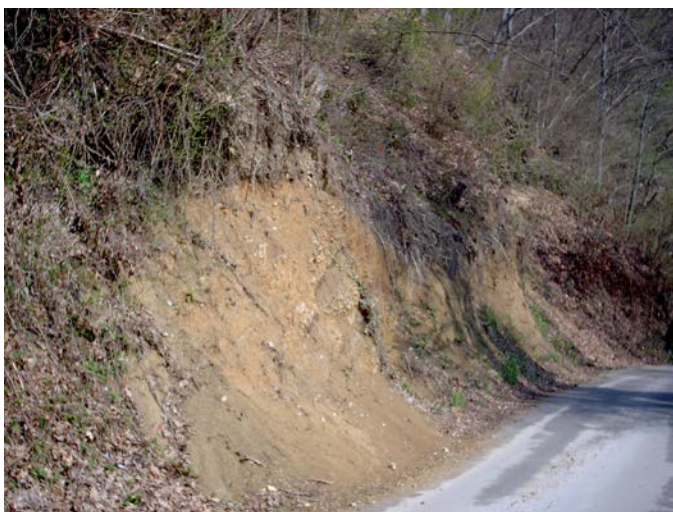
Slika 9: nezaščiten brežina na cesti LC 450170, ki drsi na cesto.
