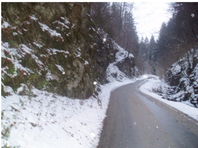
Slika 8: nezaščiten in nestabilna brežina, kjer stalno pada kamenje na cesto (LC 410090)
