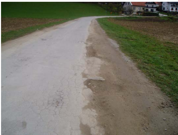
Slika 11: poškodovana bankina na cesti od Škal do Velenja
