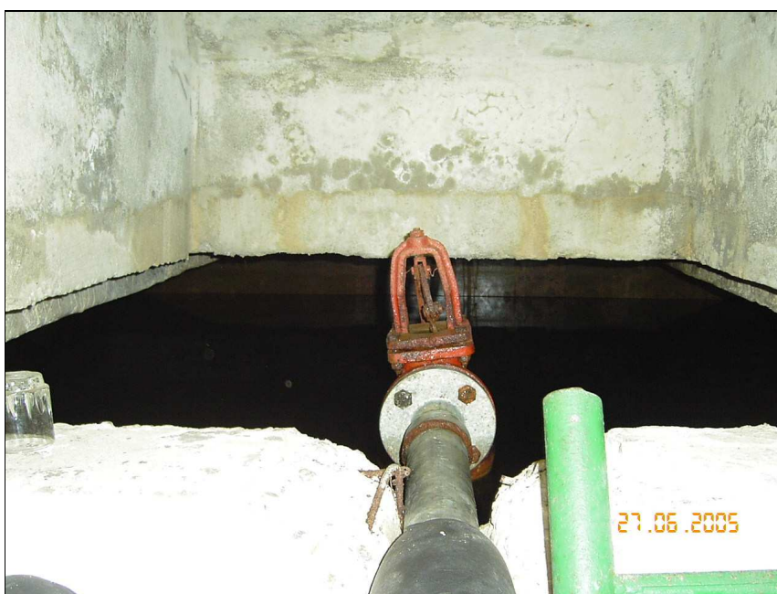
Slika 12: Rezervoar vodohrana Križe
