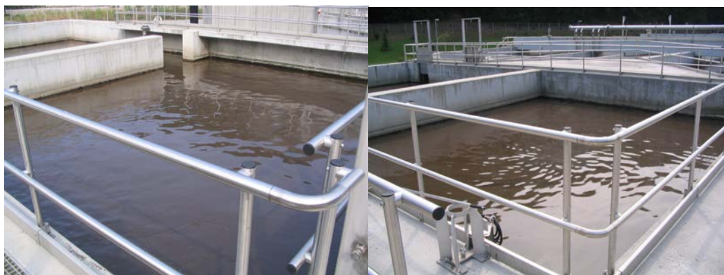
Slika 6.2: Anaerobni bazeni ČN Celje.
