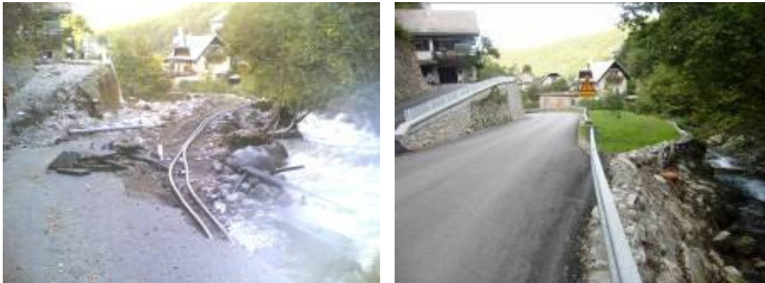
Sliki 16 in 17: Uničena struga, cesta in vodovod v območju profila 11 in urejeno stanje po sanaciji decembra 2008(foto: Bojan Okorn)
