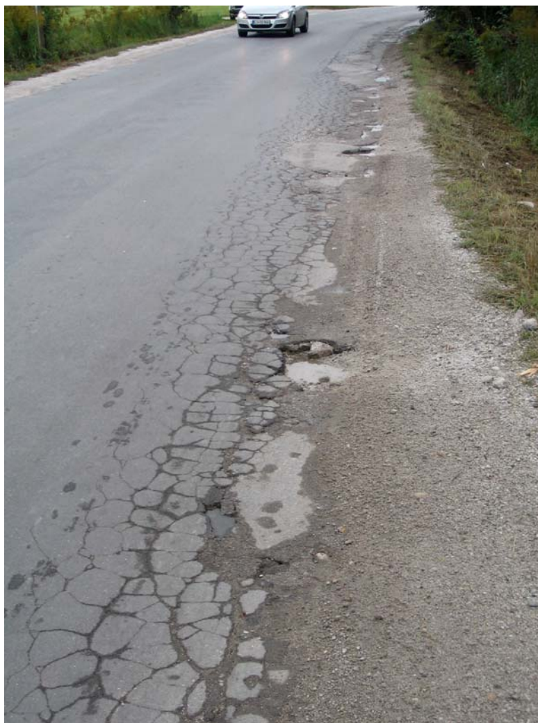
Slika 10 : Poškodovani rob vozišča
