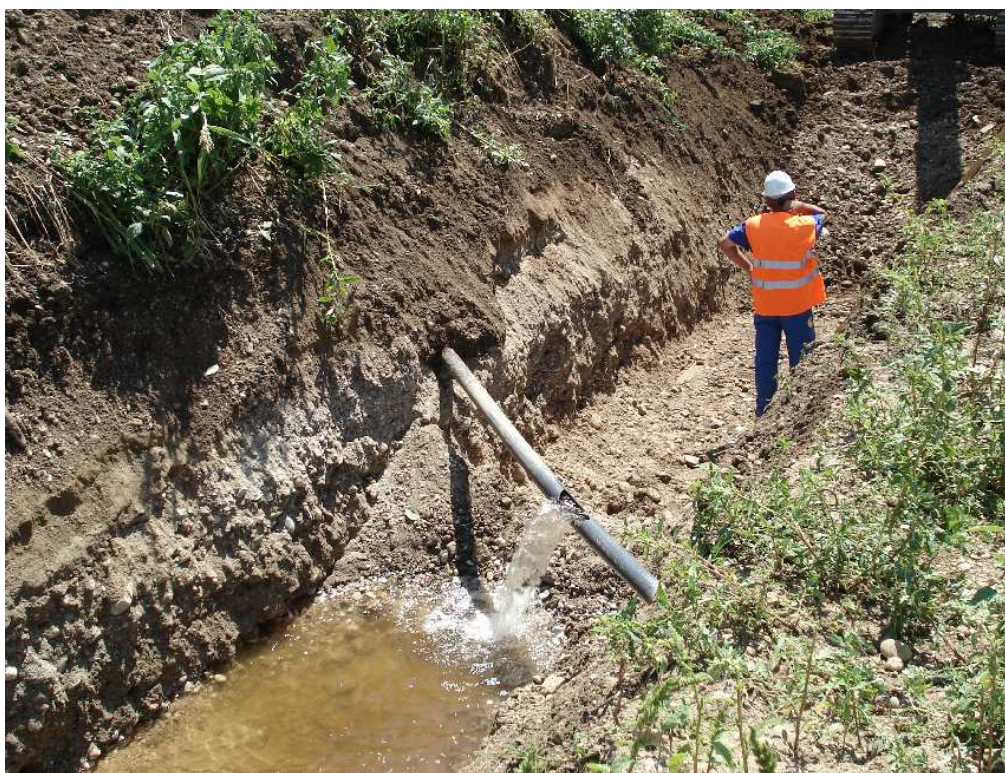
Slika 29: Poškodovana cev namakalnega sistema
