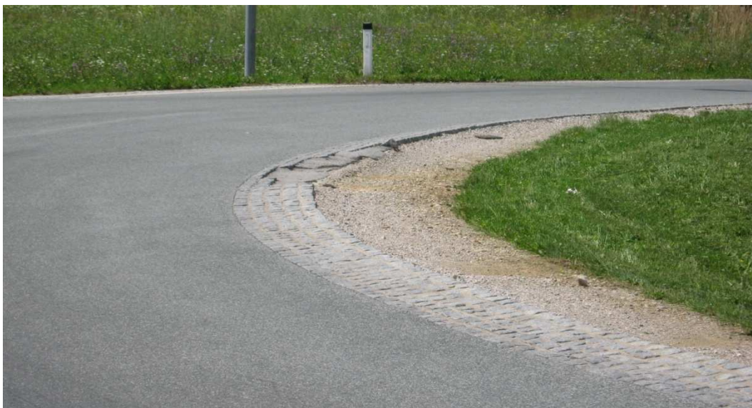
Slika 25: Erozija na notranji strani krožnega toka
