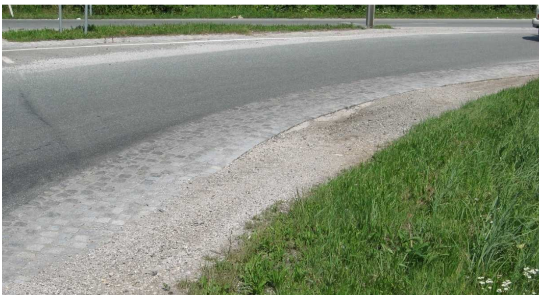
Slika 24: Erozija bankine na izvozu
