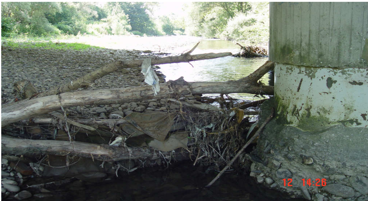
Slika 16: Primer slabega vzdrževanja struge in objektov kot je temelj avtocestnega mostu v Tacnu. (Foto: Savič sep.08)
