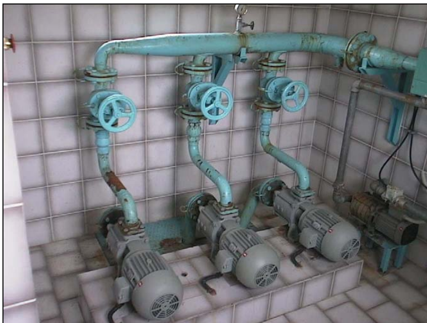
Slika 21: Črpalke na črpališču Letuš
