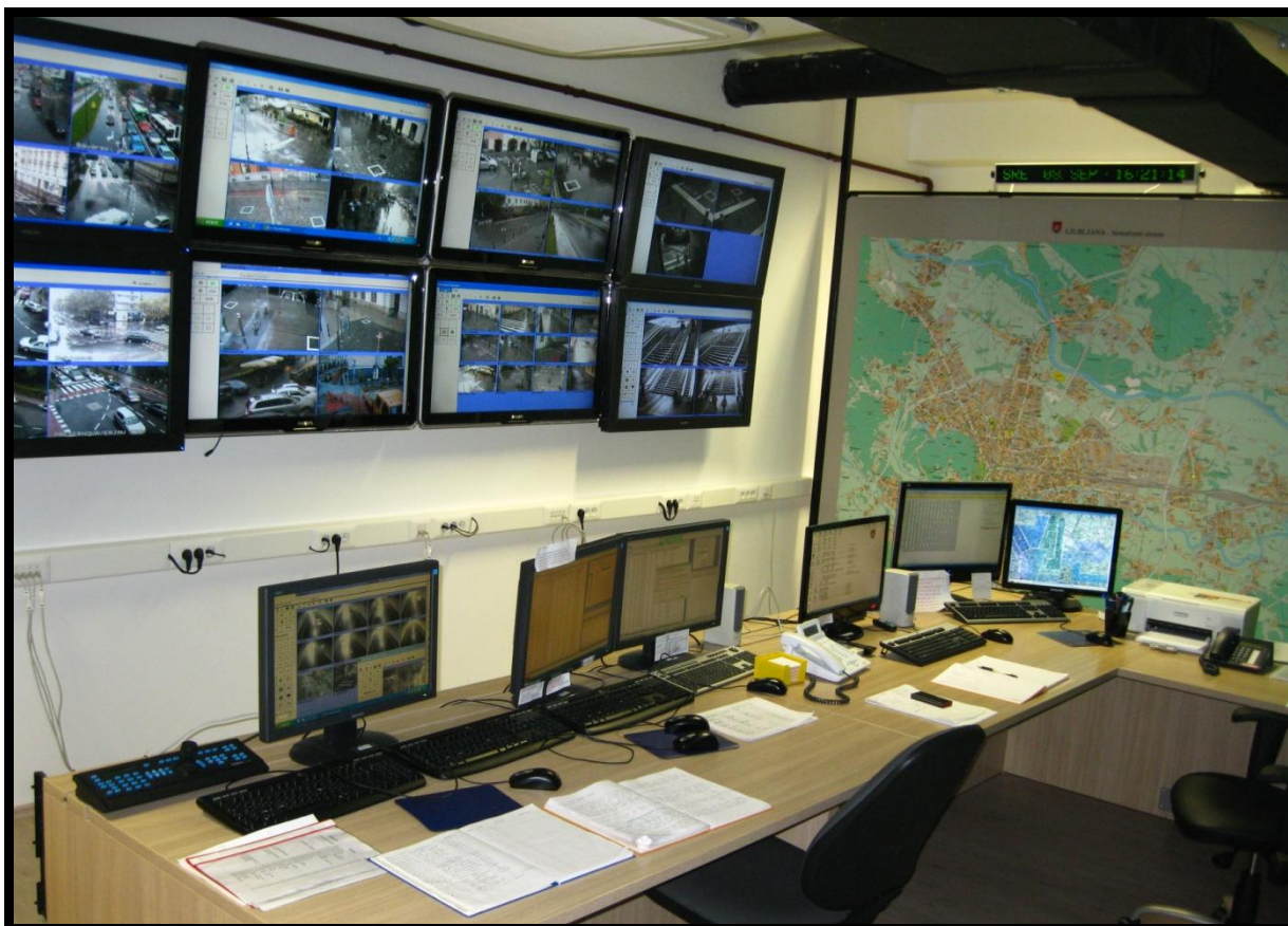
Slika 4: Center za nadzor in upravljanje prometa Ljubljana
