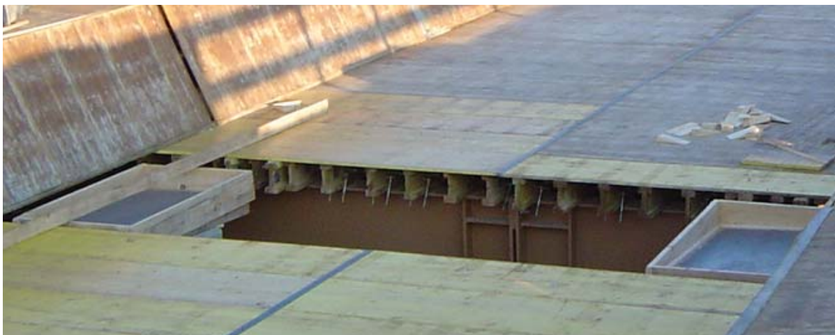
Slika 74: Opaženje takta prekladne konstrukcije v območju ležišč
