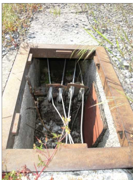
Slika 11: Žicevod v betonski kineti na postaji Ribnica (Vir 11: Škufca, 2011)
