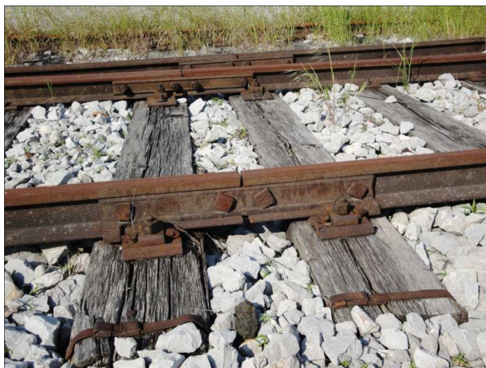
Slika 7: Dotrajane tirnice, pragi ter vezni in pritrdilni pribor na postaji Kočevje (Vir 7: Škufca, 2011)
