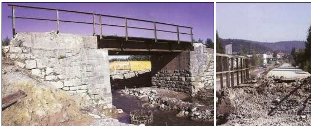
Slika 13: Dotrajani jekleni most čez Podlomščico pri Spodnji Slivnici (Vir 13: Nova proga, 2008)
