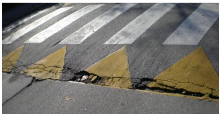
Slika 12: Poškodovanost grbine ob njenem vznožju.
