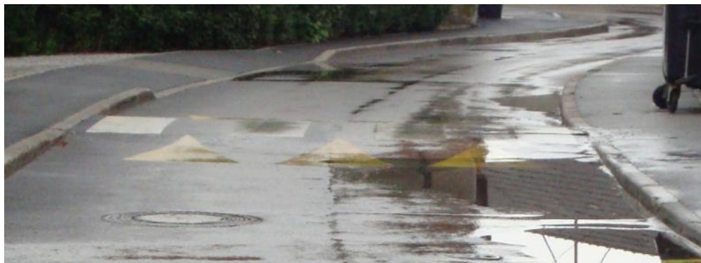
Slika 15: Neustrezno urejeno odvodnjavanje na Štepanjski cesti.
