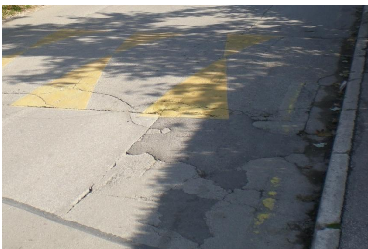
Slika 11: Prikaz poškodovanosti vozišča pred izvedeno sinusoidno grbino.
