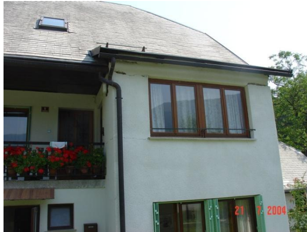
Slika 7: Vodoravne razpoke kjer je razviden premik plošče (Foto:Dolinšek, B. 2004)
