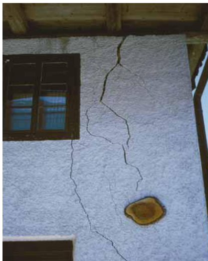
Slika 8: Globoke vertikalne razpoke na starejšem zidanem objektu (Foto: Dolinšek, B. 2004)
