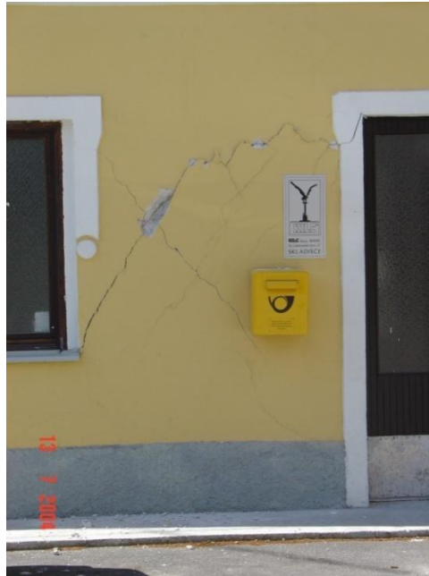
Slika 6: Tipična diagonalna medodprtinska razpoka (Foto: Dolinšek, B. 2004)
