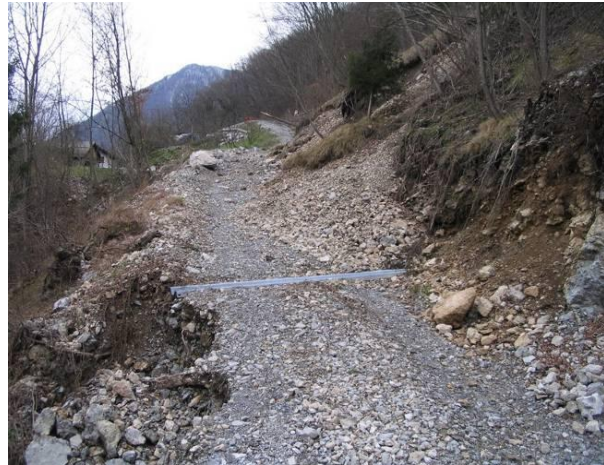
Slika 64: Poškodbe cestišča po podoru.
