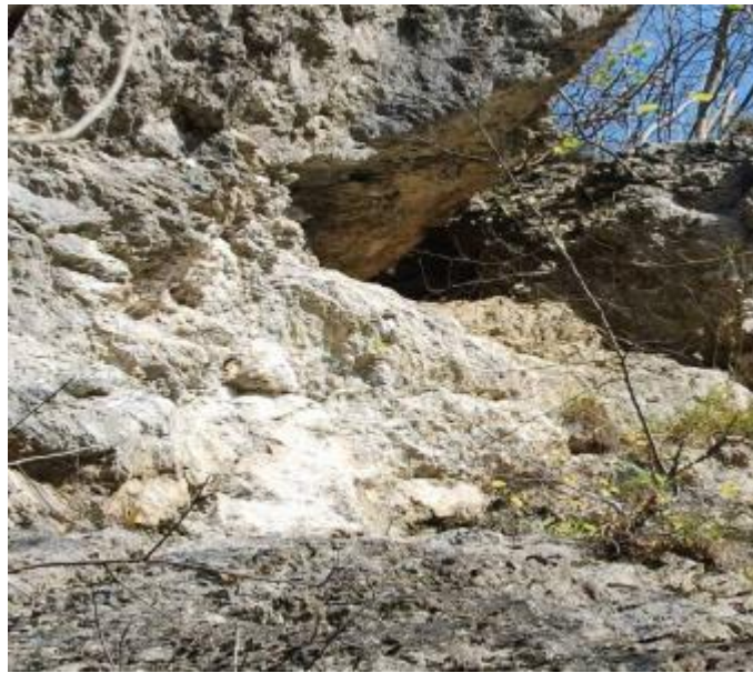
Fotografija 6: Opaziti je tudi nekaj manjših porušitev nepravilnih oblik, na mestih močne tektonske prizadetosti dolomita, še pogosteje pa v dolomitni breči
