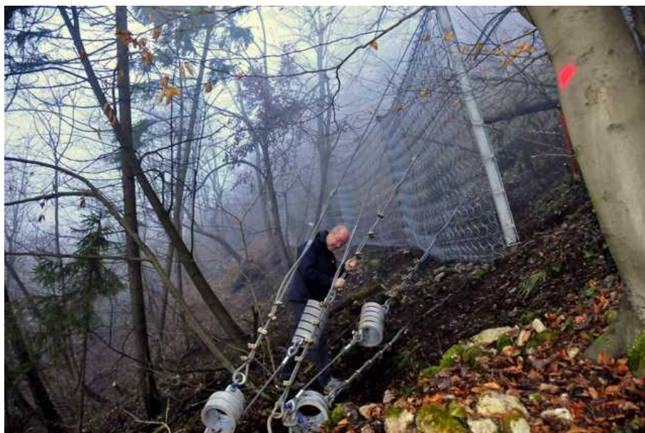
Slika 13: Zavorni obroči pri 1.000 kJ sistemu (foto: Ivnik M.).
