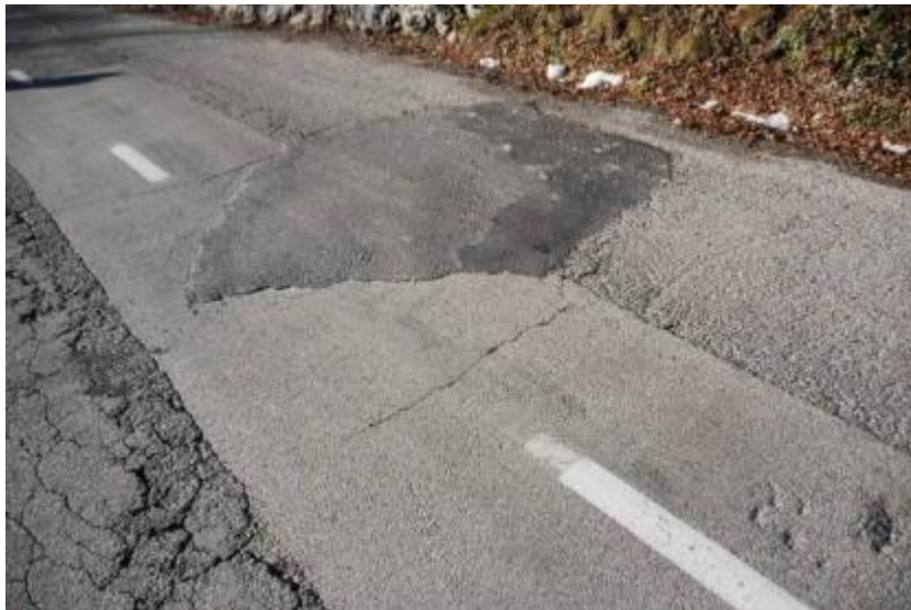
Fotografija 16: Na regionalni cesti pod kritičnim območjem je opaziti številne znake padanja skal in kamnov. Slika kaže mesto padca velike skale na cesto, ki je bila ponovno asfaltirana in v spodnjem desnem kotu odtise padanja manjših kamnov.
