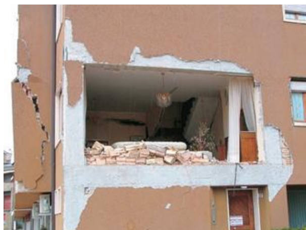
Slika 5: L'Aquila - Porušeno polnilo pri AB okvirni stavbi (Vir: Cecić, Godec, 2010)
