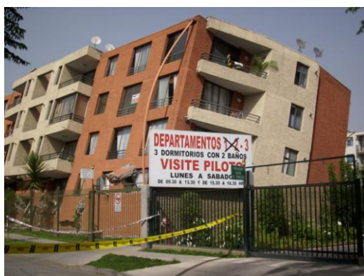
Slika 13: Čile - Novogradnja poškodovana zaradi likvifakcije tal (Vir: Oxfam Canada, 2010)
