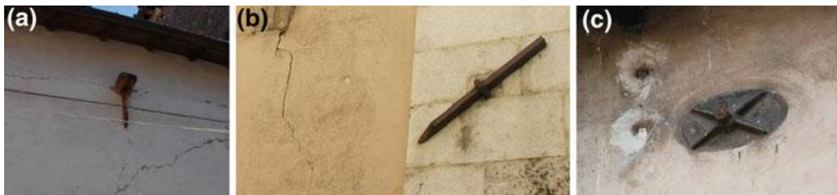
Slika 4: L'Aquila - Potresne ojačitve zidanih stavb: (a) lesena vez, (b) vez iz kovanega železa vstavljen v robni steber zidu, (c) jeklena vez iz 20. stoletja (Vir: D'Ayala, Paganoni, 2010)
