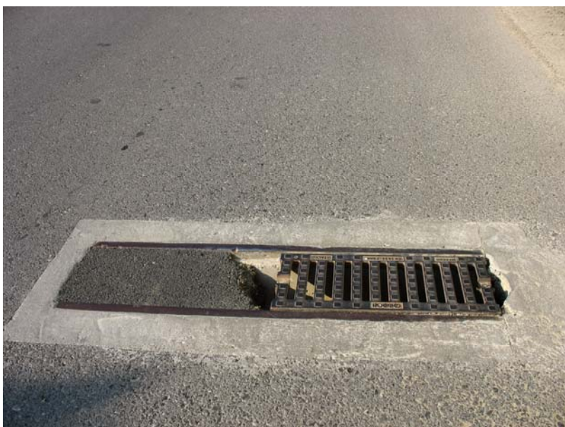
Slika 16: Kolesarjem zelo nevaren nepravilno izveden jašek
