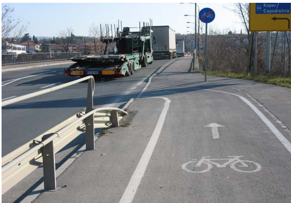
Slika 54: Nepravilno izveden prehod kolesarske steze v mešani profil
