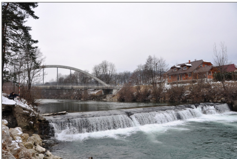
Slika 6: Mozirski jez: Lepo so vidne poškodbe prejšnjih poplav, v ozadju Ločki most (foto: Gašper Zupančič)
