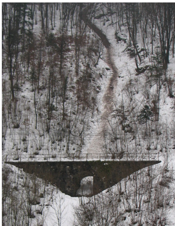
Slika 37: Na levi sliki je primer potencialno nevarne grape, katere zaključek je speljan skozi kamnit prepust pod železnico (foto: Trojer, 2010).
