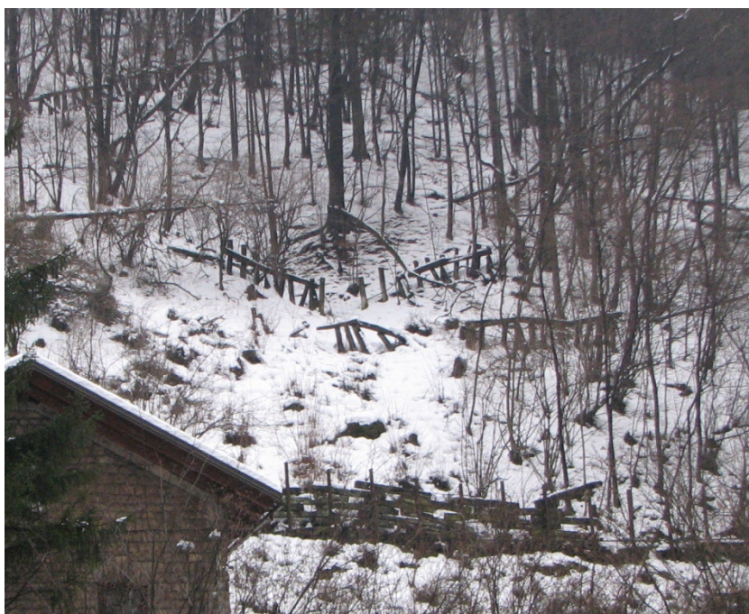
Slika 38: Poškodovani snežni mostovi nad železniško progo med Podbrdom in Hudajužno so očitno potrebni popravila (foto: Trojer, 2010).
