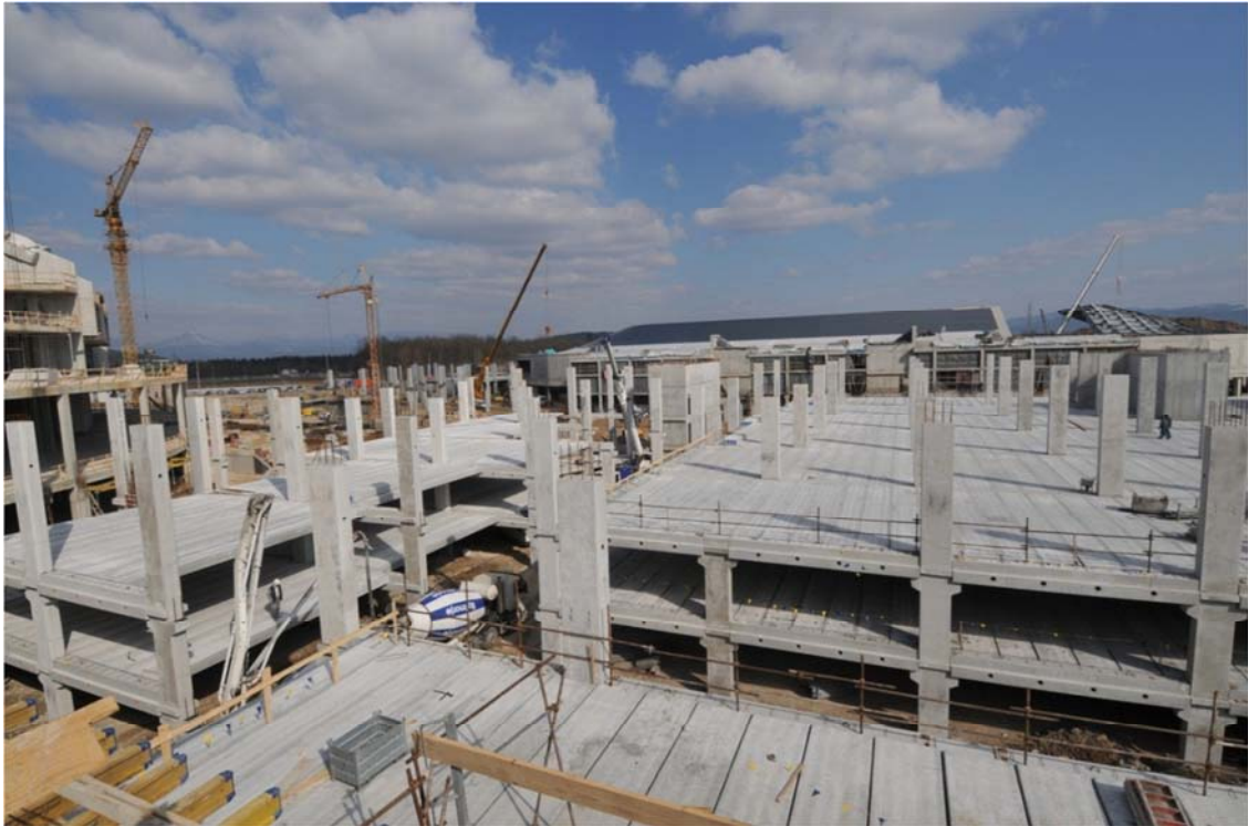
Slika 1: Dober montažni konstrukcijski sistem gradbenega podjetja Primorje, ki je bil uporabljen na gradbišču v Stožicah v Ljubljani
