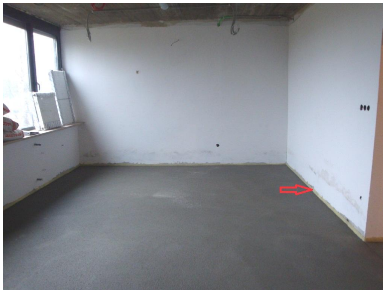
Slika 17: Estrih debeline 4 cm; s puščico označen trak izolacije med stikom z vertikalno konstrukcijo
