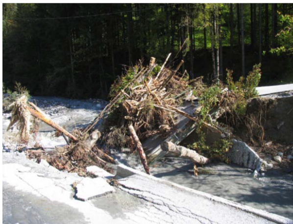
Slika 1: Lokalna zajezev plavja na mostni konstrukciji v spodnjem toku Davščice, ki je povzročila nekajmetrsko zajezev in verjetno udarni vodni val zaradi porušitve »jezu« (foto: Mikoš, 22. 9. 2007)
