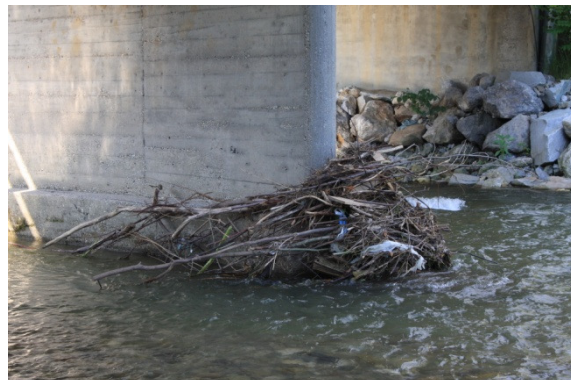
Foto 2: Sledi naloženega plavja na stebru Kovtrovega mostu
