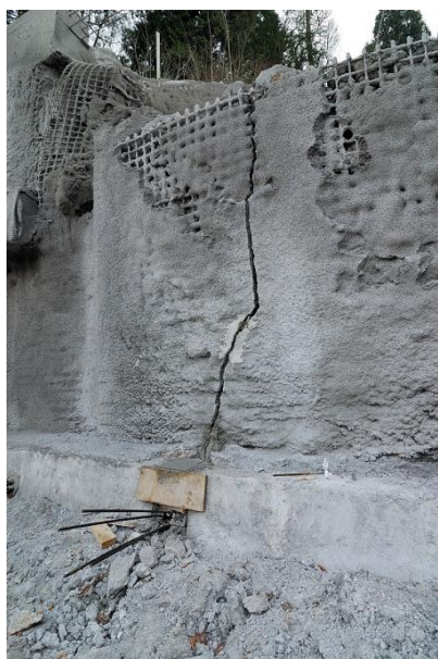
Slika 5: Razpoka na konstrukciji
