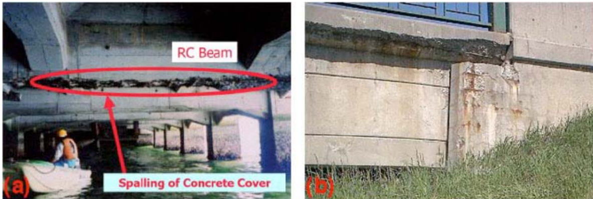
Slika 52: Korozija armiranega betona: (a) objekt v stiku z morskovo vodo, (b) poškodba AB mostu Vir: D.J. Naus, 2007
