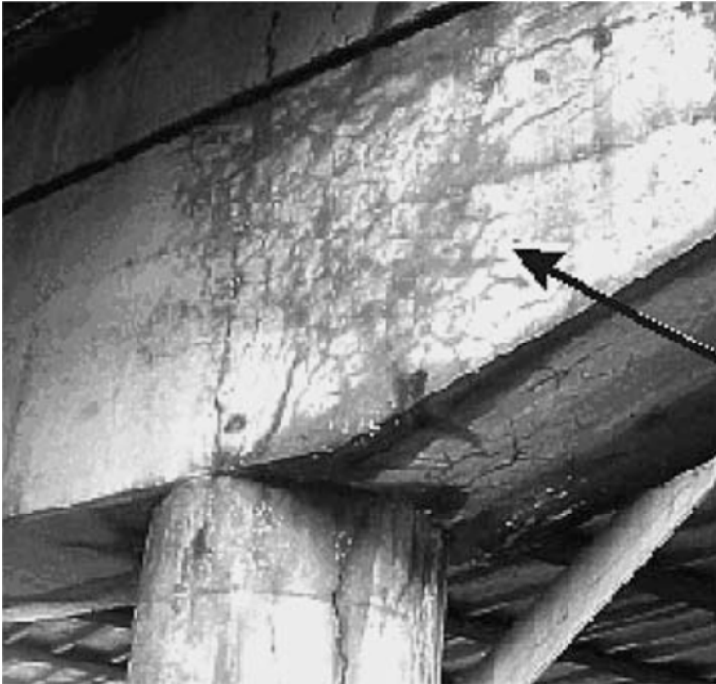
Slika 45: Razpoke v betonu zaradi zapoznelega oblikovanja etringita. Vir: www.fhwa.dot.gov/publications/transporter/04jul/index.cfm#adv
