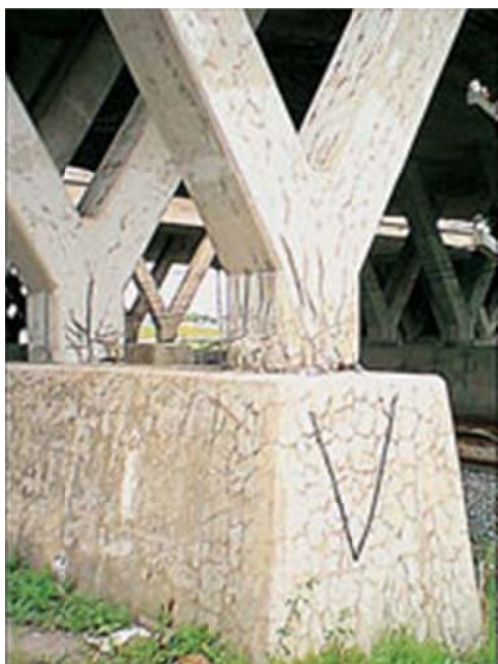
Slika 47: Poškodba objekta zaradi ASR
