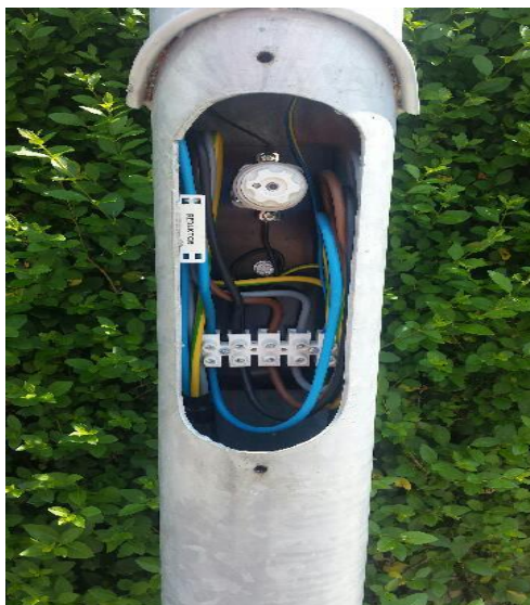
Slika 4: Kabelska omarica javne razsvetljave (Vigred d.o.o.)
