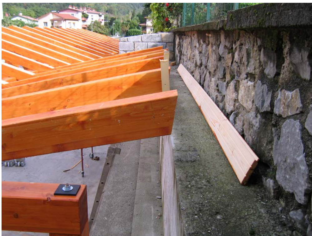
Slika 38: Prekratki špirovci lesene nadstrešnice
