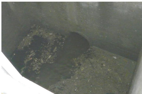
Slika 45: Dotok odpadne vode iz kanalizacije v CČN Celje
