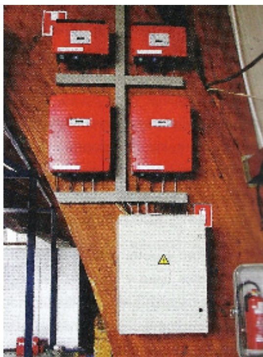
Slika 20: Razsmerniki za 20 kW sončno elektrarno (vir: Otorepec, 2009)
