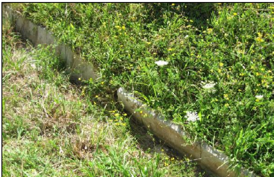
Slika 1.4: Poškodbe na površinskih odvodnikih zaradi nabrekanja podlage (foto. A. Petkovšek).
