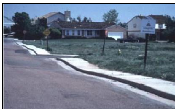
Slika 3.2: Poškodba prometnice zaradi nabrekanja.
