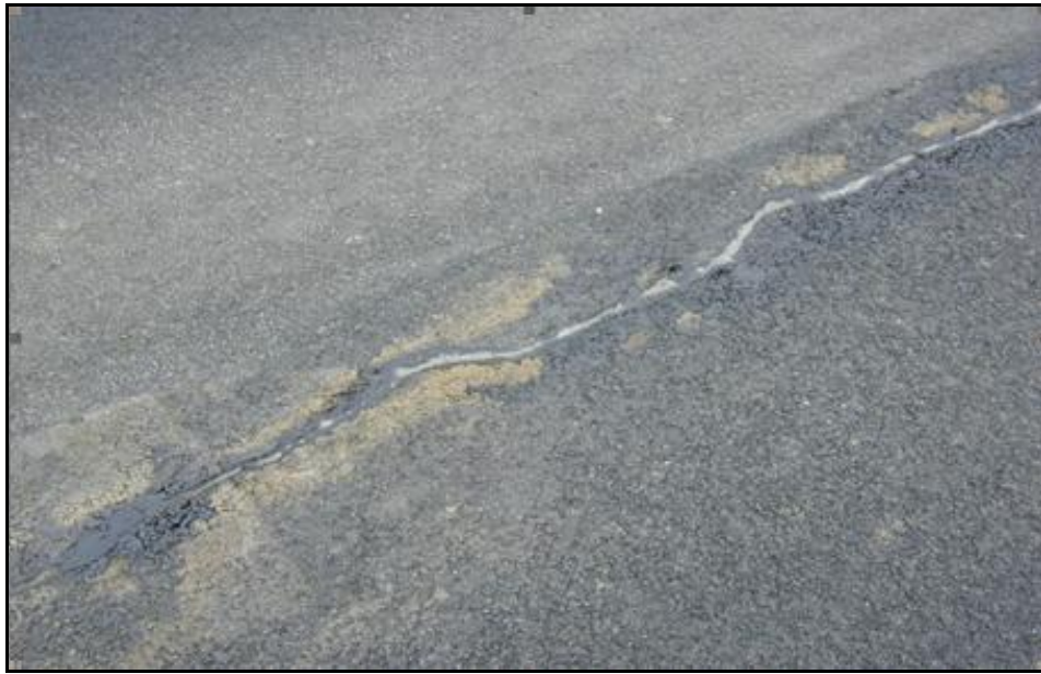
Slika 1.3: Poškodba novozgrajenega vozišča avtoceste (foto. A. Petkovšek).
