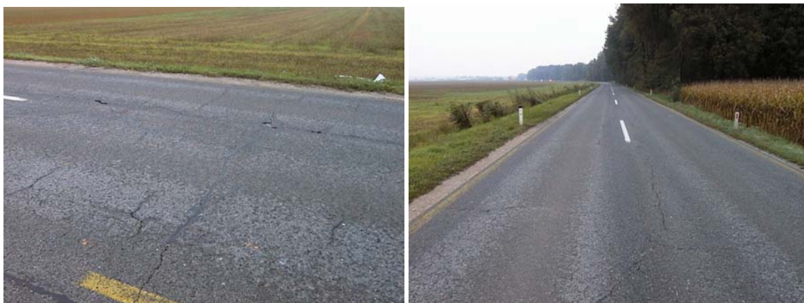
Slika 5.1 in 5.2: Poškodbe na vozišču pred preplastitvijo
