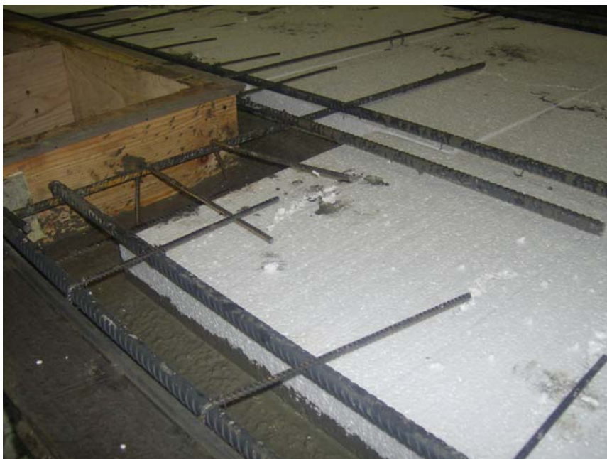
Slika 11: Toplotni most pri odprtinah v fasadnih elementih debeline 20 cm
