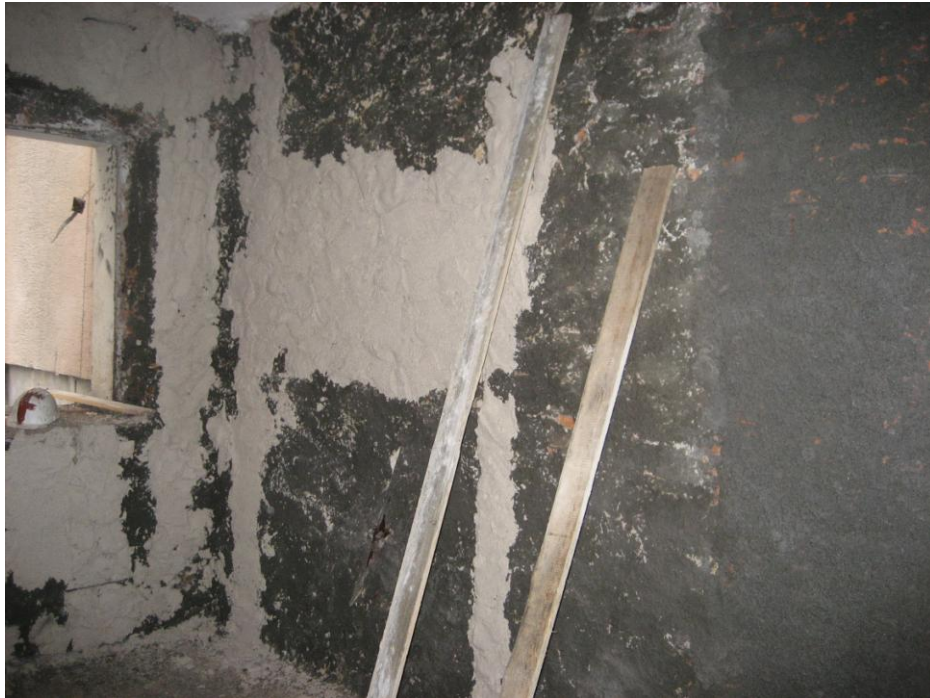
Slika 4-26: Nanos mineralnega hidrofobnega ometa.
