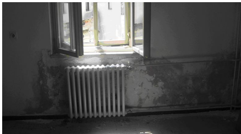
Slika 5-21: Vlaga v zidu povzroča odpadanje ometa.
