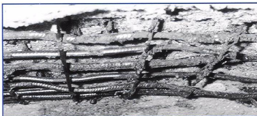
Slika 1: Poškodbe armiranobetonskega elementa med požarom
